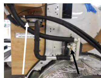
Échangeur thermique, booster
