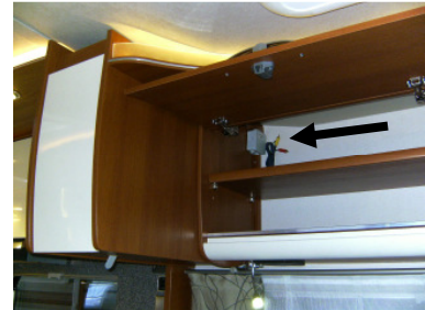
Boîte de distribution près du placard TV
