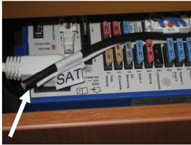
Précâblage sur le chargeur
