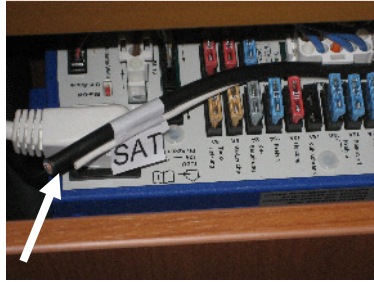
Vorverkabelung bei Ladegerät
