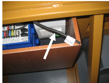
Vorverkabelung bei Ladegerät
