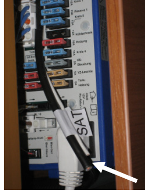
Vorverkabelung bei Ladegerät
