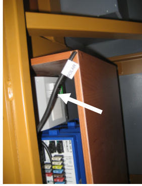
Vorverkabelung bei Ladegerät
