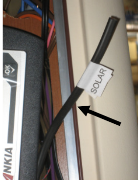
Vorverkabelung bei Bedienpaneel
