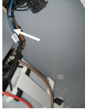
Vorverkabelung bei Aufbauatterie
