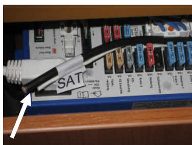
Vorverkabelung bei Ladegerät
