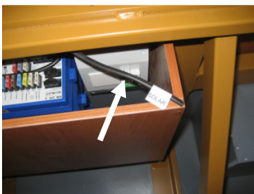
Vorverkabelung bei Ladegerät
