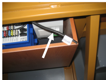
Vorverkabelung bei Ladegerät
