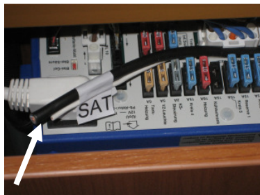
Vorverkabelung bei Ladegerät
