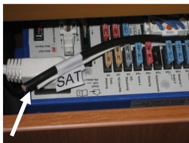
Vorverkabelung bei Ladegerät
