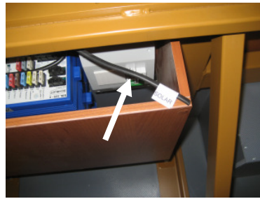
Vorverkabelung bei Ladegerät
